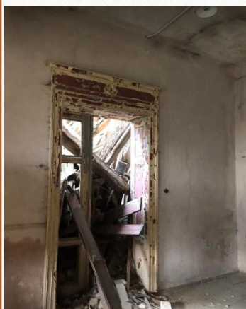
Zawalony dach w jednym z pomieszczeń
