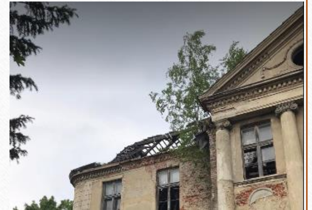
Wyrwa w dachu (zdjęcie własne)
